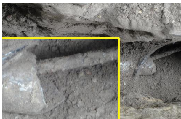
Figuur 3.11: Asbest cement mantelbuizen voor kabeldoorvoeringen
